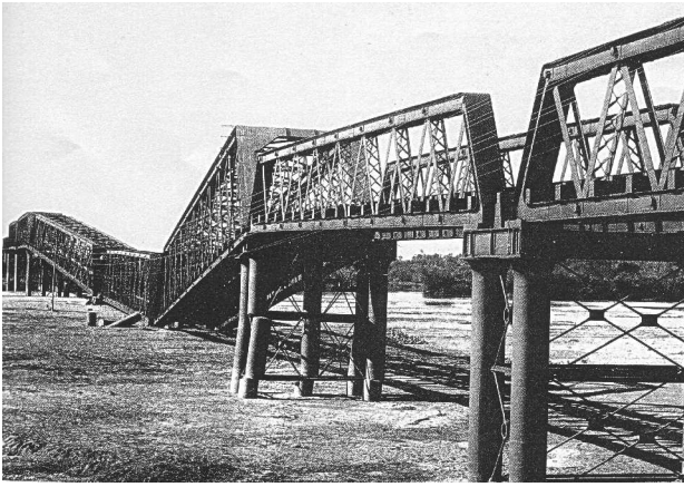
写真-3 濃尾地震により震害を受けた鉄橋脚 (出典：文献24)plate26)
